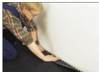
Enkel oppbrett ved kanten.
